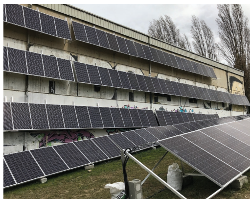
Errekaleor auzoko panel fotovoltaikoak. ARG.: Txo/Wikipedia CC 4.0.
