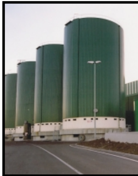
Coruñaako Biogas instalazioetan sortzen duten elektrizitatearekin hiriko kaleak argitzen dituzte.
