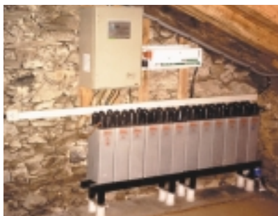
Instalazio fotovoltaikoa barnealdetik.
