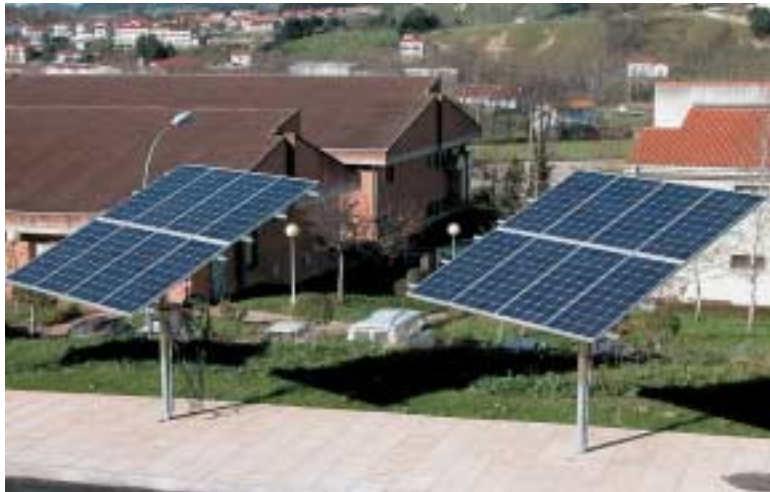
Usurbilgo Lanbide Eskolan instalatutako panel fotovoltaikoak.
